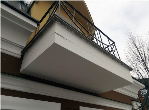
Рис. 1. Деструкция штукатурного и декоративно-отделочного слоев
