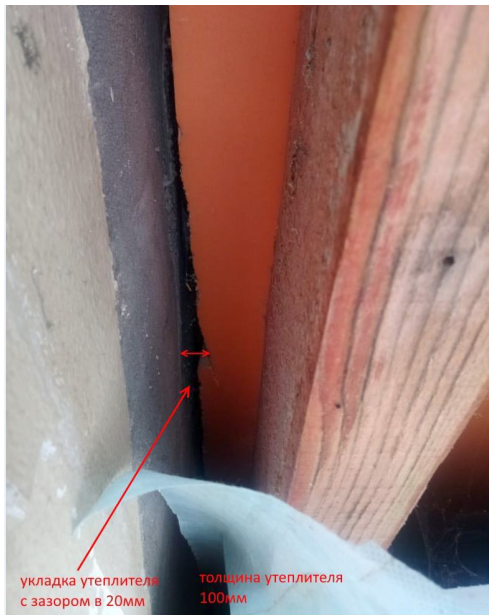
Рис. 10. Зазор между утеплителем и стеной
