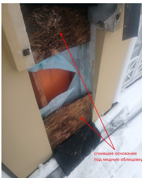
Рис. 8. Сгнившее основание под медной кровлей
