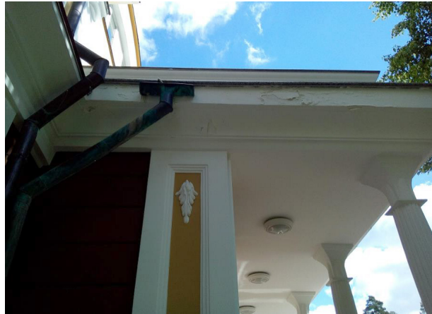
Рис. 2. Трещины, отколы штукатурного слоя
